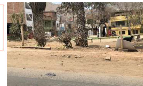
Ausencia de veredas y rampas de acceso.
