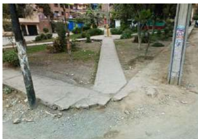
Veredas en deterioro.
