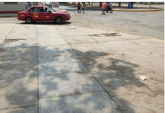
Las veredas tienen rajaduras y huecos en ciertas partes.
