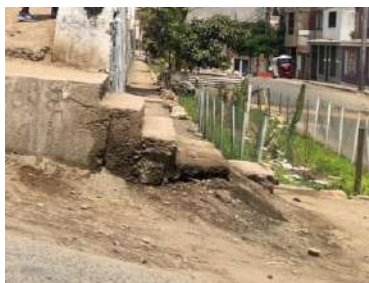
Escalera de ingreso en mal estado.
