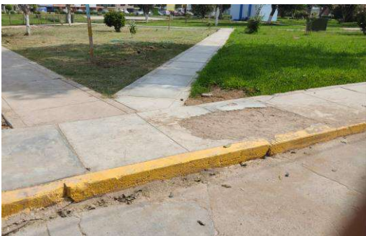
Tiene veredas gastadas y con rajaduras.
