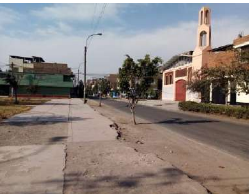
Sus veredas están en descuido total, por lo que presentan muchas rajaduras.
