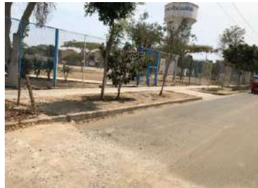
Vías de acceso y veredas deterioradas
